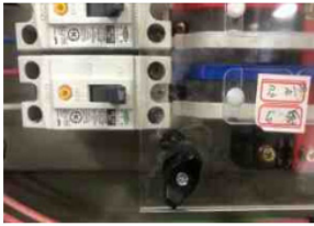
〈사례1 - 누전차단기 설치〉
